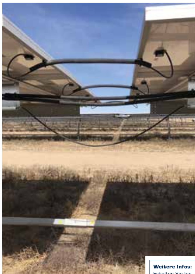
Flexible Leitungsführung nach Anordnung der installierten Photovoltaikmodule
