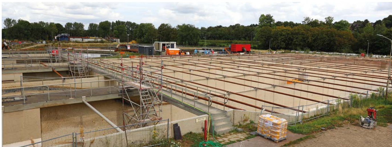
Blick auf das Belebungsbecken
