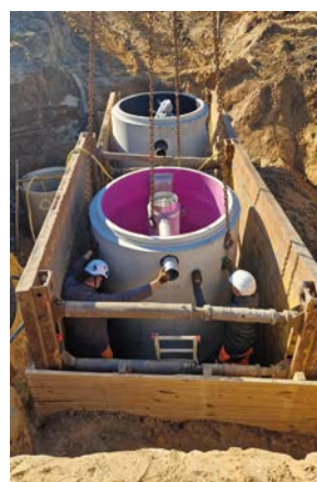
Die FUCHS Abscheideranlage schützt das Grundwasser an einem Bauhof in Spremberg vor Verunreinigung
