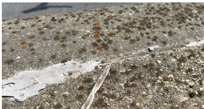
Schaden an zwei aneinanderliegenden BSWs: Polysulfid-Dichtstoff auf Oberseite
